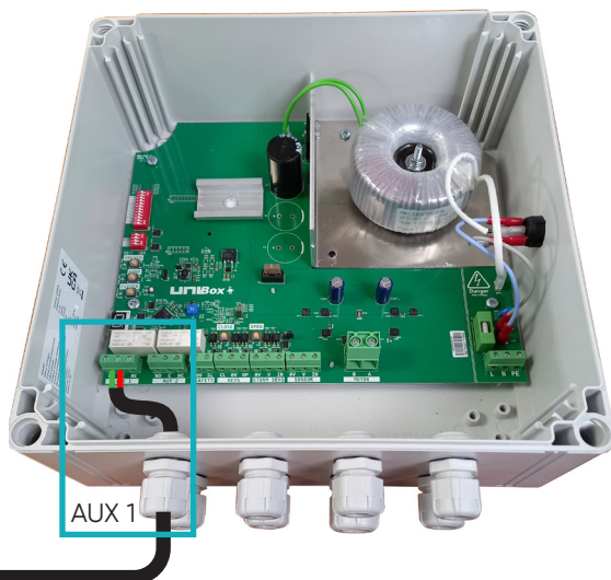
Електричний щит Unibox
